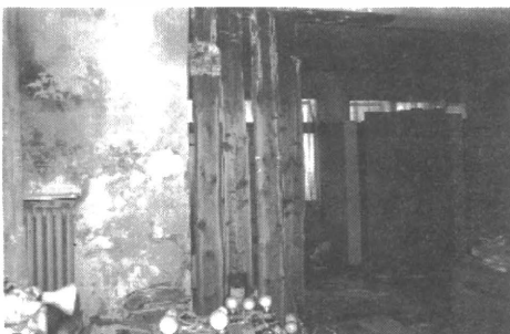
Zniszczenia budynku spowodowane grzybem i wilgocią
